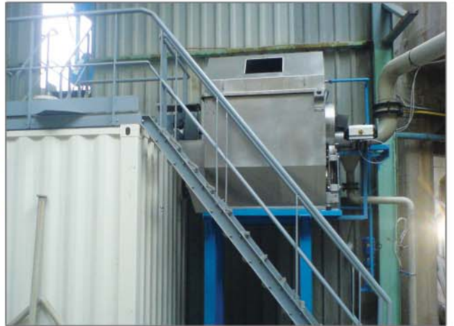
Belquim Storm water filtration
